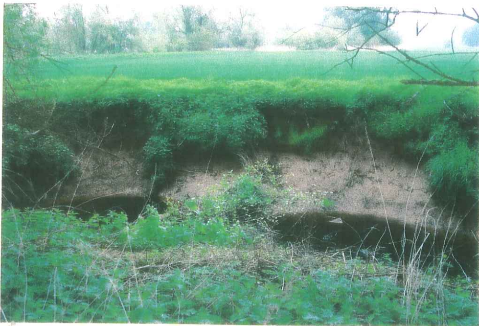
Bild 9: Ems unterhalb der L 3218 - . Das Gewässer weist ein sehr tiefes Querprofil und fast im gesamten Gewässerabschnitt erhebliche Erosionserscheinungen auf. Eine - zum Teil intensive - Flächennutzung reicht bis zur Böschungsoberkante.
