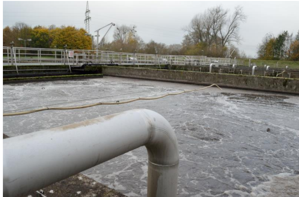
Belebungsbecken 1, im Hintergrund 2, 3+4
