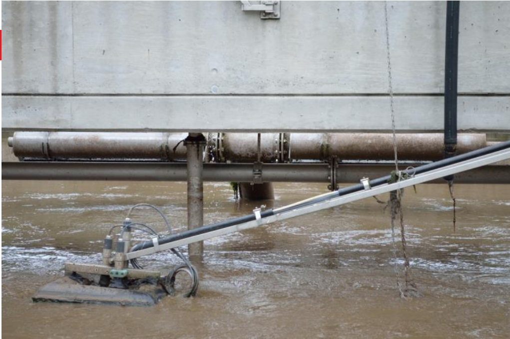
Dosier- und Messstelle in den beiden SBR-Becken Essigsäure, PAC
