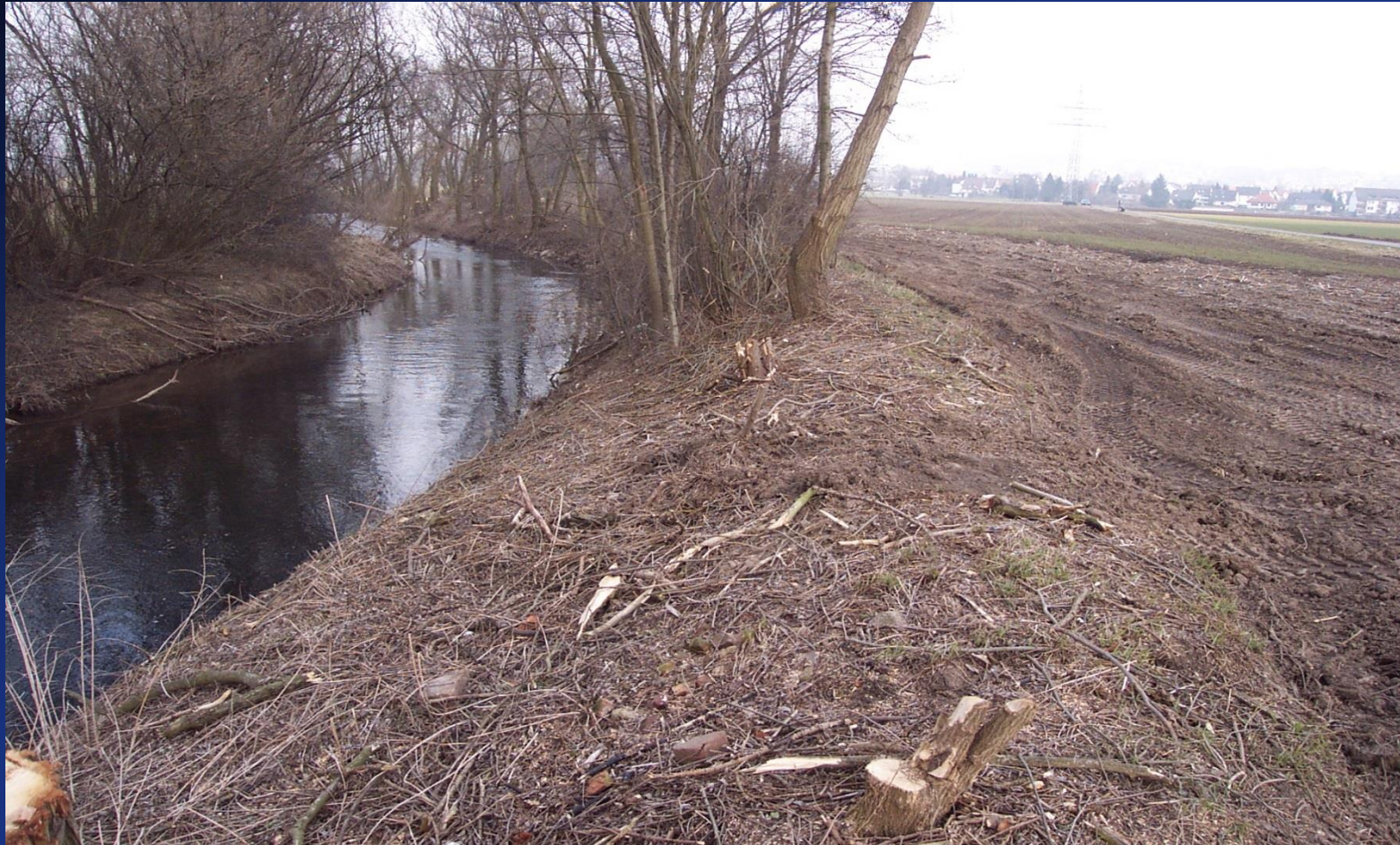
Strukturell defizitärer Abschnitt der Losse randlich von Kassel
