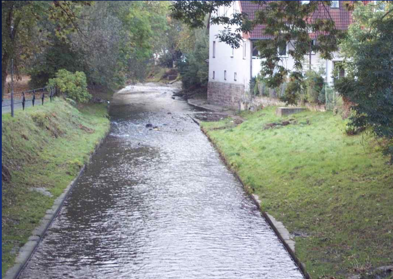
Strukturell stark geschädigter Abschnitt der Lose im Kasseler Stadtteil Bettenhausen
